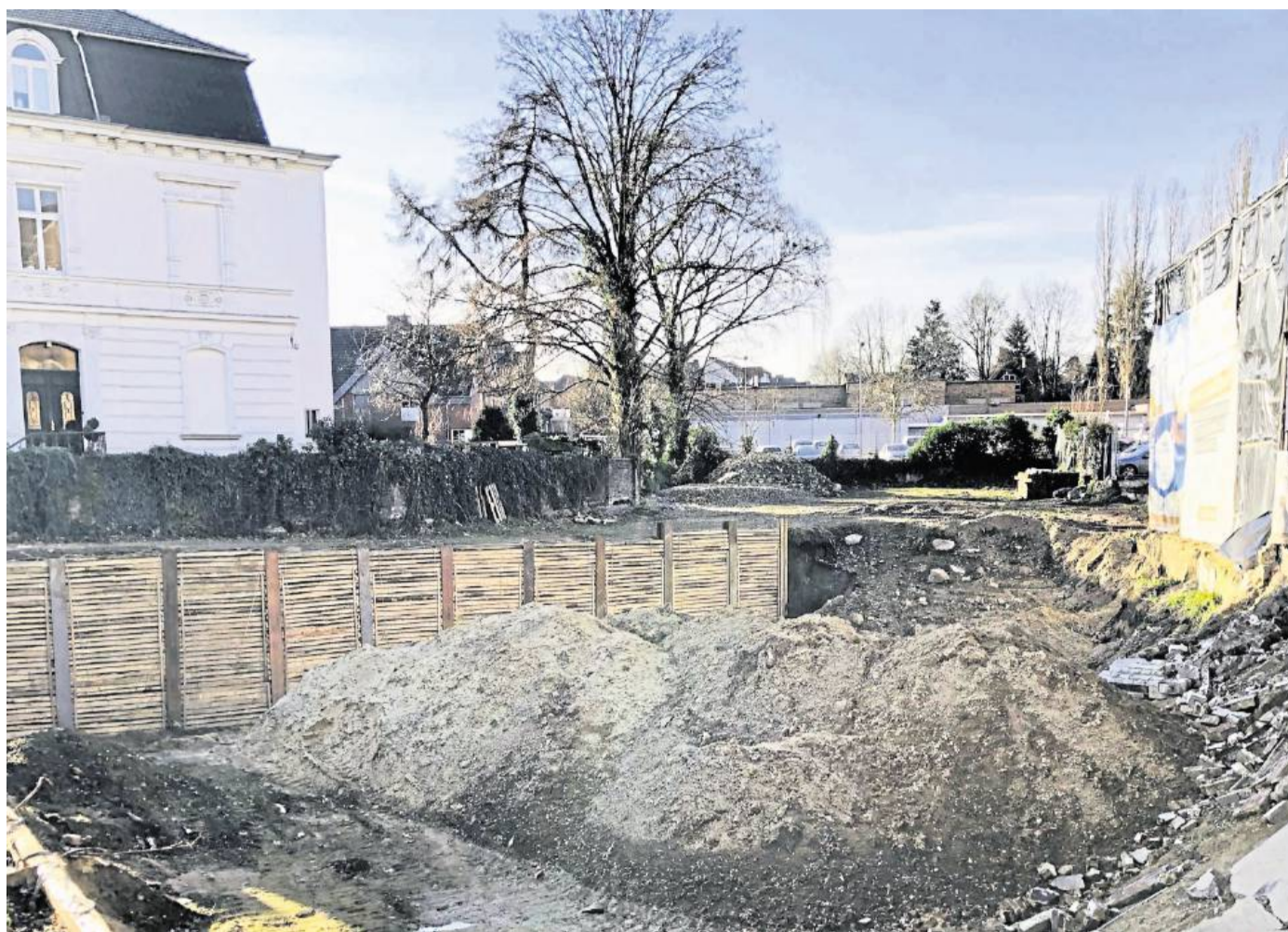
Dauerbaustelle Hertener Straße: Viel getan hat sich seit dem Abriss im vorigen Jahr nicht. Neben an die Villa mit der denkmalgeschützten Fassade. —FOTO: WIETHAUP
